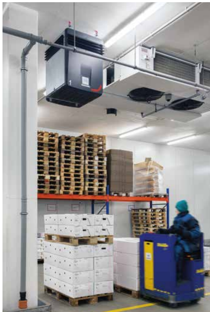
De luchtzuiveringssystemen werden direct aan de zones met hoge stofbelasting geplaatst om de deeltjes uit de lucht te filteren op de plek waar ze ontstaan.
