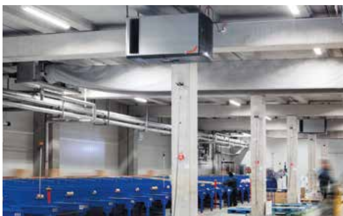
Er wordt gebruik gemaakt van luchtzuiveringssystemen van het model Zehnder CleanAir 3, waarbij het stof met behulp van zeer fijne polypropyleenvezels wordt afgescheiden.
